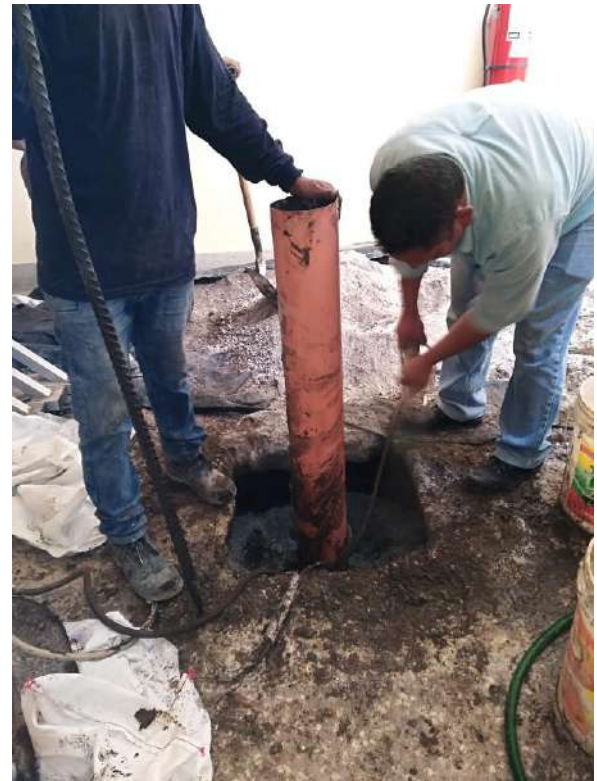
Pozo a tierra vertical
