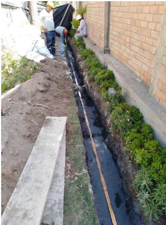
Pozo a tierra horizontal
