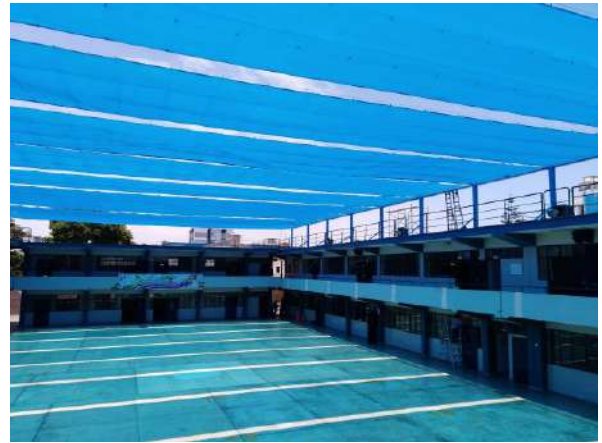
Sistema de toldos plegadizos con motores
